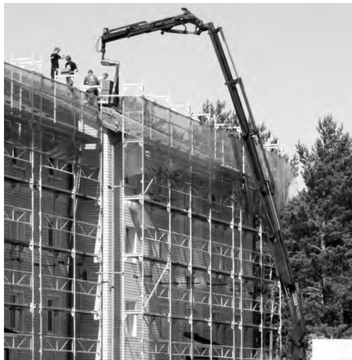
Takbyte på Kärngatan. Ett av de mest höglyftande projekt som Keijo L Bygg AB åtagit sig var takbytet på Bostadsrättsföreningen Kämmakaren 8 i somras. Nybyggen är sällsynta i Hälleforsnäs men det befintliga fastighetsbeståndet börjar bli gammalt och behöver en hel del omsorg.
